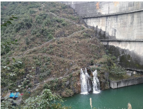
图4 大坝右岸下游渗漏点
