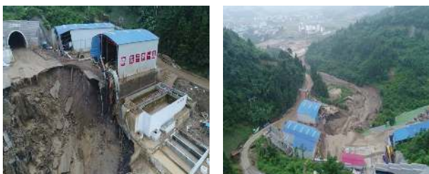
洞口施工场地毁损情况
