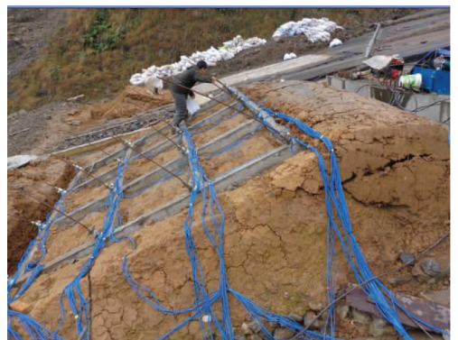
图6 加载破坏后的格构梁
