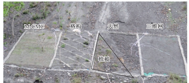
(a) 降雨冲刷后边坡现状
