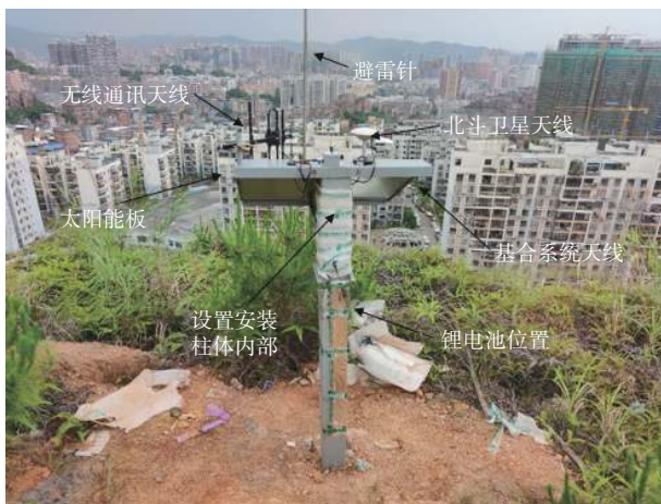
图4 基合主设备结构及现场情况
