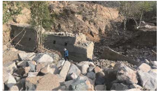
图 3 区内拦砂坝受冲击破坏损毁
