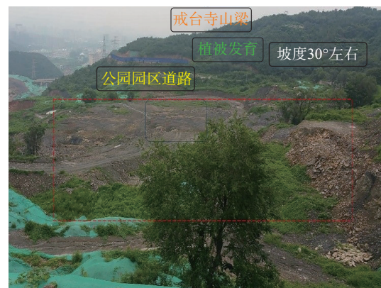
图 1 边坡加固前照片
