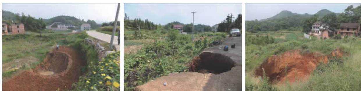
照片4 岩溶塌陷所表现出来的陡坎效应
