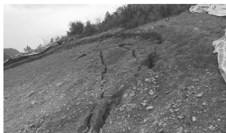
图1 后缘下错及产生的裂缝
