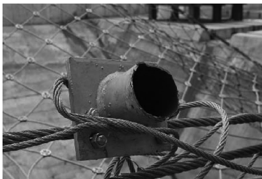
图 17 T-2 冲击试验后钢柱 3 柱脚脱落图
