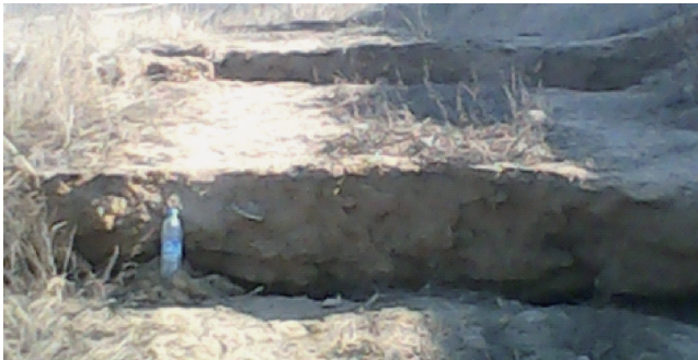
图 10 地表拉伸区的台阶裂缝
