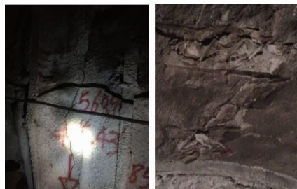
图 1 初期支护变形破坏
