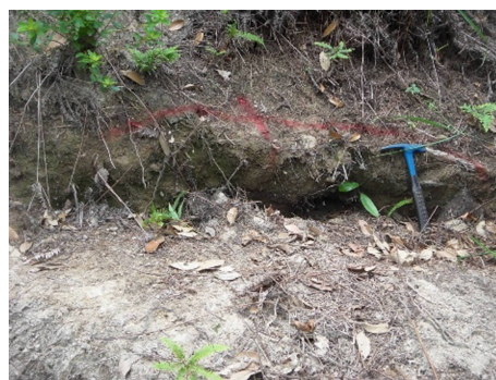
图 3 滑坡前缘张拉裂缝
