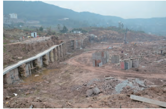
图4 某在建工程深厚层土质滑坡前缘照片
