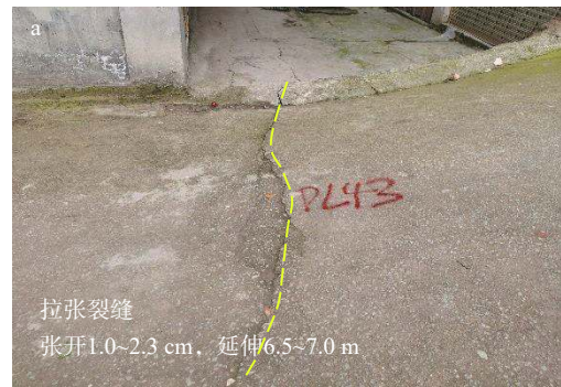
(a) 地表拉张裂缝
