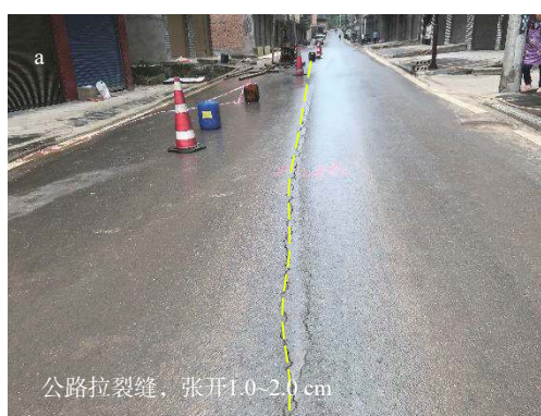
(a) 道路拉伸裂缝
