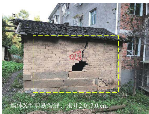
(b) 墙体X型剪断裂缝
