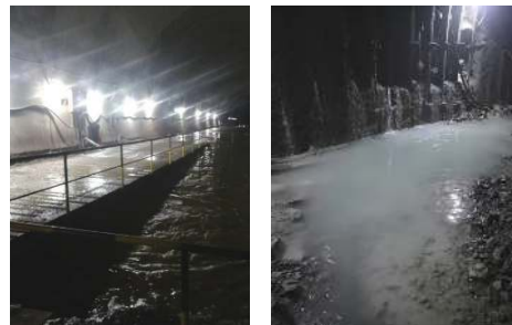
(a) 雨季洞内涌水被淹 (b) 非雨季洞内涌水 图 11 庙子坪隧道洞内涌水 Fig. 11 Water gushing in MiaoZiPing tunnel
