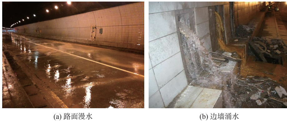
图 4 媯双坳隧道水害事故图 Fig. 4 Flood accident photos of Pishuangao tunnel
