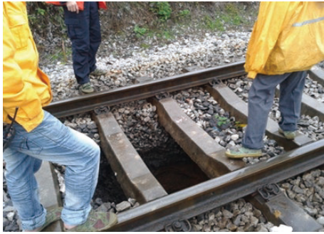
A、2012 年 11 月 8 日,二塘站 K368+900 处塌陷坑,宽 1.5 m、长 2.5 m、深 3.5 m。
