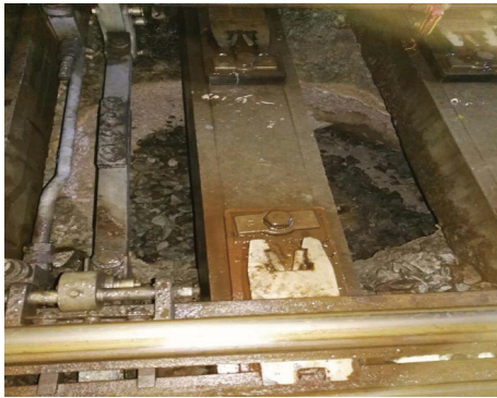
B、2016 年 11 月 10 日 1 时 59 分,二塘站内 K353+970 处道心内塌陷坑,直径 1.5 m,深 2 m
