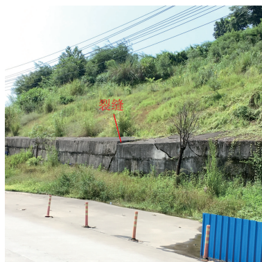
图 3 坡脚挡墙裂缝
